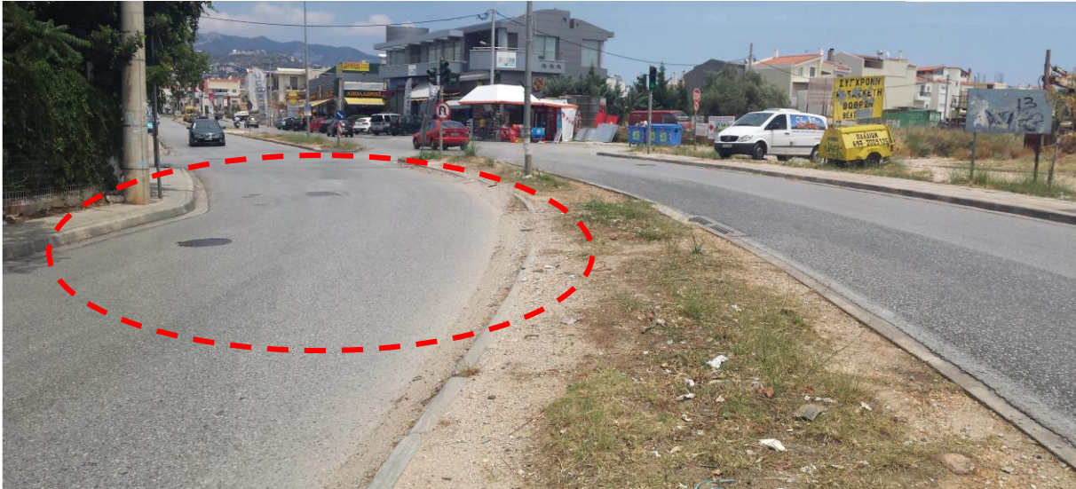
Φωτογραφία 3.9-1: Οδός Ηρακλείτου περί τη χ.θ. 0+760. Λήψη φωτογραφίας προς Πεντέλη. Στην υφιστάμενη κατάσταση διακρίνεται εμφανώς ότι η δεξιά οριογραμμή του οδοστρώματος δεν συνάδει με τα «as build» σχέδια. Μικρότερο πλάτος νησίδας, μικρότερο πλάτος οδοστρώματος, μικρότερο πλάτος πεζοδρομίου με επικίνδυνη «κόγχη».
